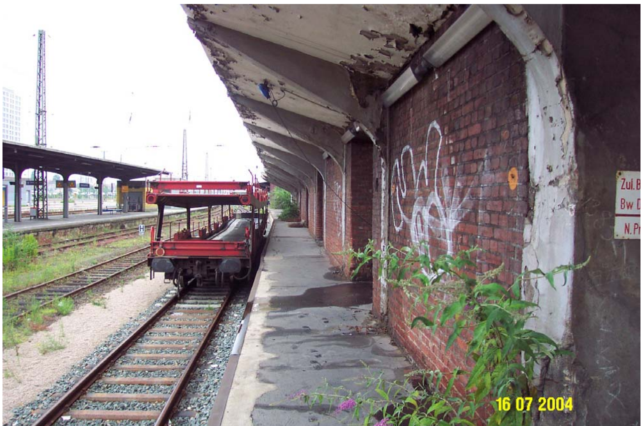
Stillgelegte Bahnsteige und Gebäude
