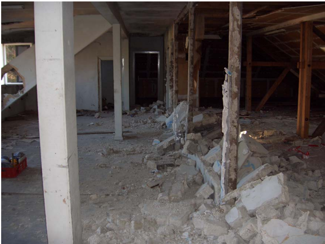
Dachstuhl mit behandelten Hölzern und unsortierten Schuttablagerungen
